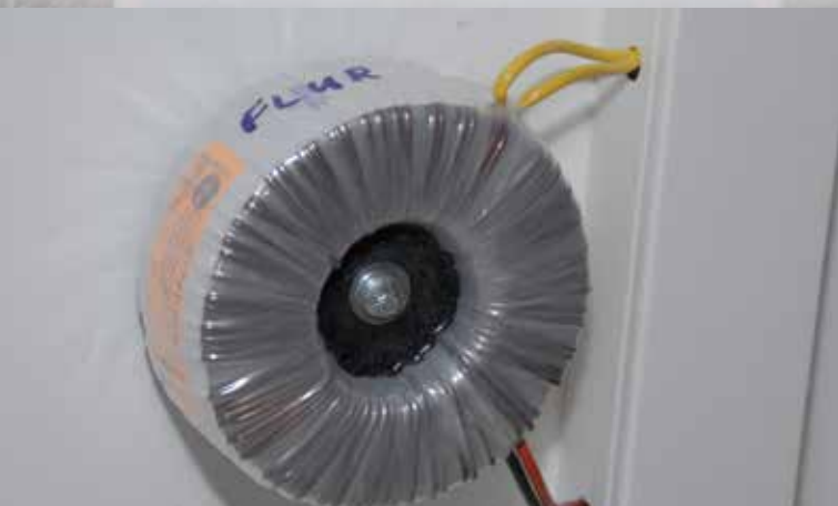
Trafo (sowie Stromkabel und Schalter) sind angeschlossen. Hier wird die Netzspannung von 230 V in 24 V Schutzkleinspannung transformiert.
