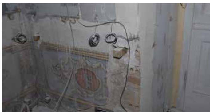
Die Aussparungen im Sockel des Wattleauzimmers nehmen die Trafos auf.
