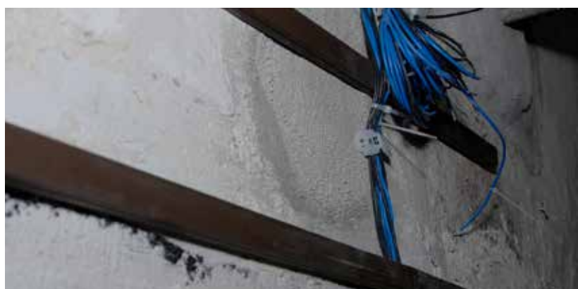
Die Kabel aus den Kupferstreifen laufen im Kühlraum nach oben aus, werden in einer Kabelleiste gebündelt und anschließend gesammelt zum Trafo geführt.
