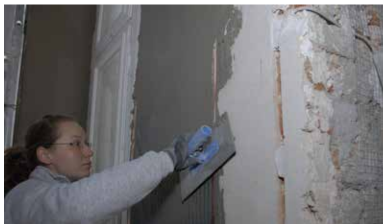
Mit der Glattkelle wird die Heizfolie in den Mörtel gedrückt und der Putz glatt abgezogen.
